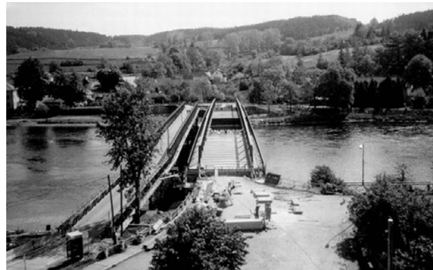
Most prodělal velkou rekonstrukci v roce 1999, zleva byl postaven druhý provizorní most, který sloužil pro pěší. Provoz aut byl řízen jednosměrně až do slavnostního otevření. Foto: Obec Kamýk nad Vltavou
