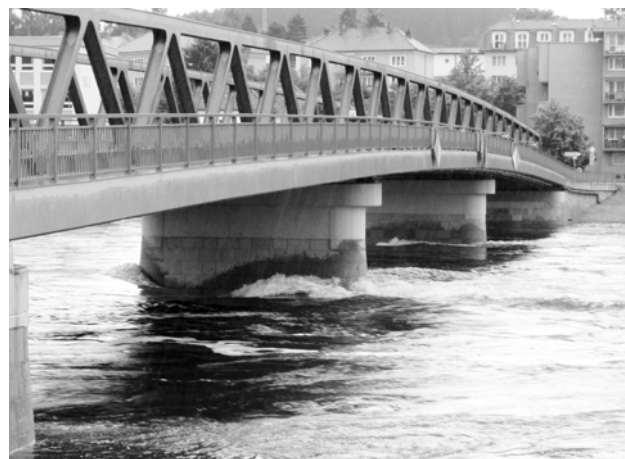
Při povodni v roce 2013 voda velkou silou tlačila na konstrukci mostu. Foto: David Štverák
