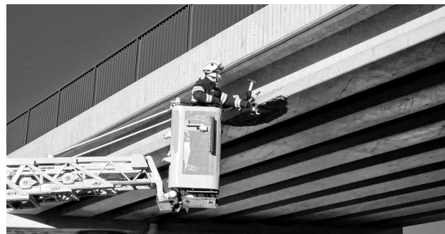
Most u Olbramovic prochází v těchto dnech rekonstrukcí.
