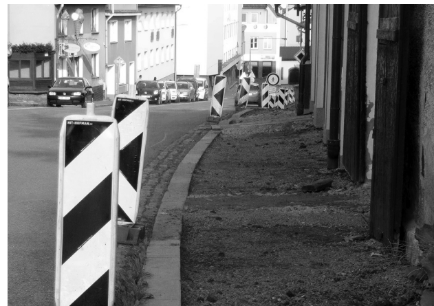
Výkopové práce v Sedlčanech hned tak neskončí. Optické kabely se pokládají také v Havlíčkově ulici.
